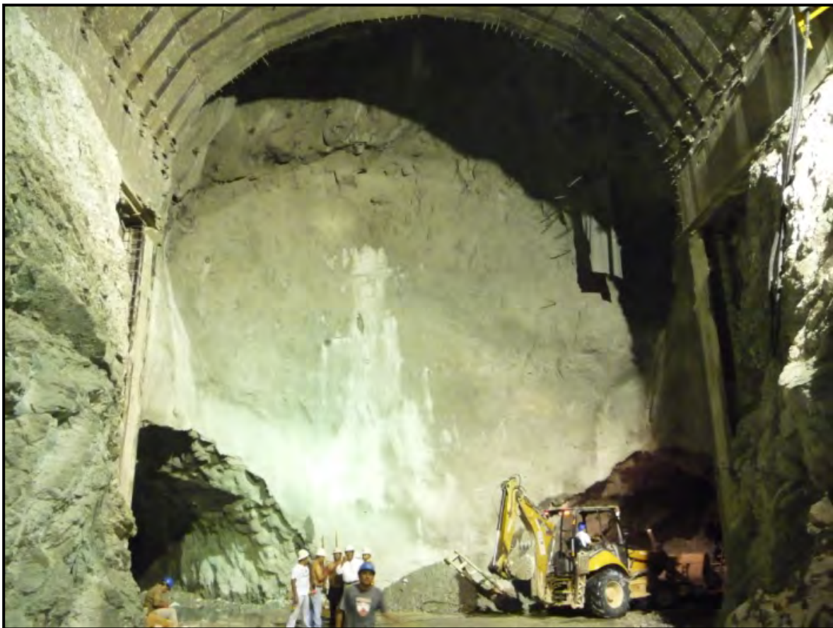
Figura 7.19 Excavación de la media sección inferior en intersección con galería de oscilación
