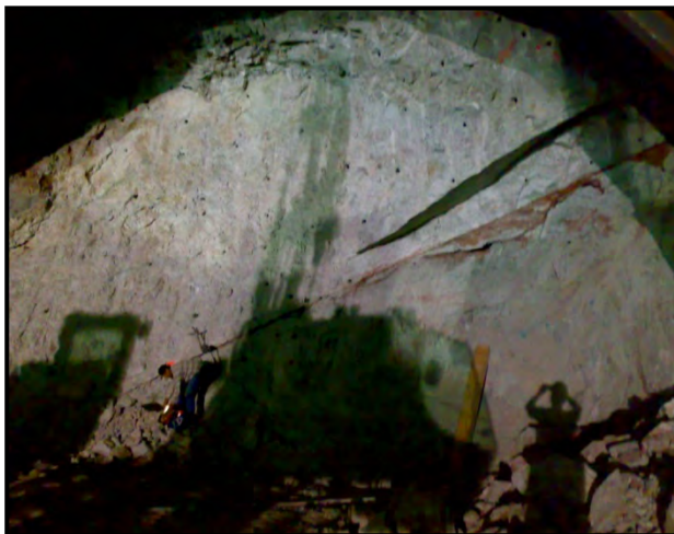
Figura 4.23 Falla interceptada en Túnel de Desvió
