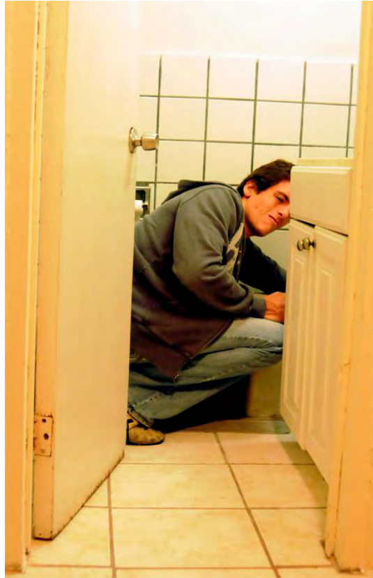
Marco reparando la tubería de la casa. Tijuana, BCN. 10 de septiembre del 2009.
