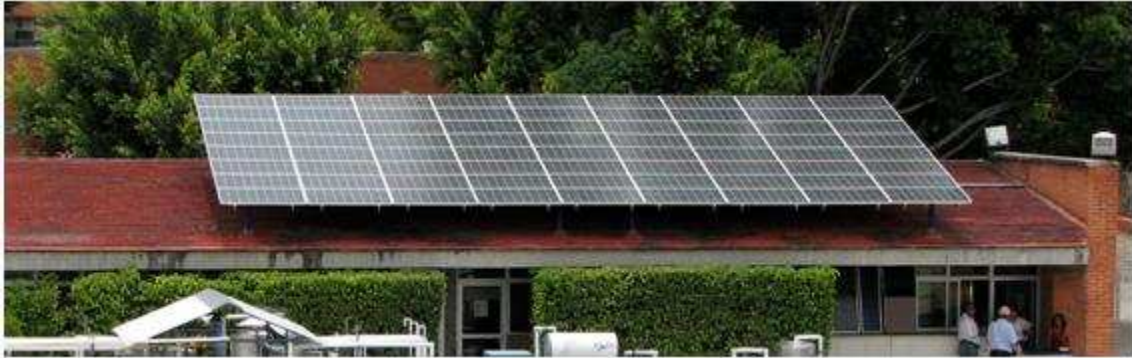
Fig. 3- 2 Arreglo fotovoltaico del CIE-UNAM
