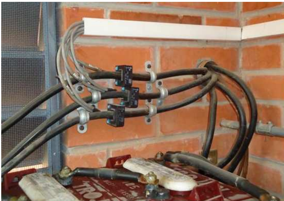
Fig. 3- 28 Sensores bidireccionales instalados para medir la entrada de los inversores
