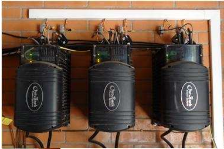
Fig. 3- 29 Transformadores de corriente y de voltaje instalados en las salidas de los inversores
