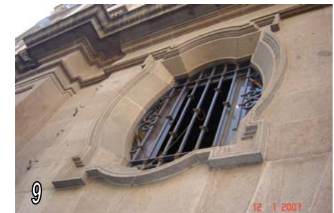
Fotos: 5. Puerta de acceso principal; 6. Puerta de acceso al estacionamiento; 7 y 8. Deterioro de la pintura en las fachadas laterales, de los cubos de iluminación y de la fachada posterior; 9. Ventana de cuadrifolio de la fachada principal, el estado de la cantera en general es bueno.
