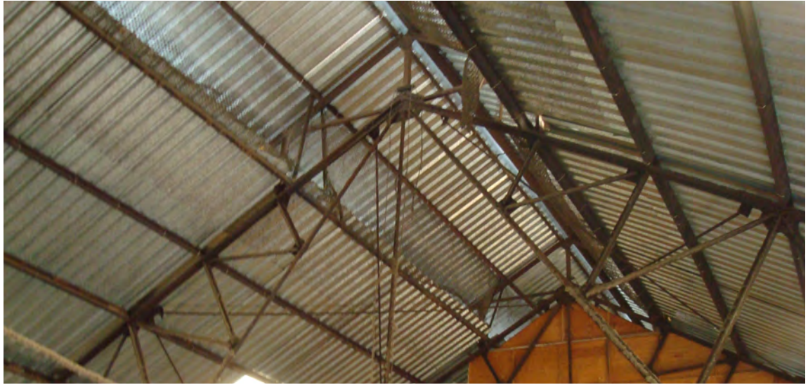
Figura 33. Estructura de la cubierta de las bodegas de granos de "La castellana" donde se puede apreciar la separación para la salida de gases. Fotografía tomada por la autora, México, 2008.
