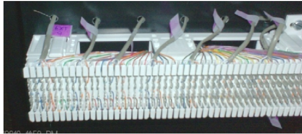
Figura 114. Cables telefónicos etiquetados con sus respectivas extensiones
