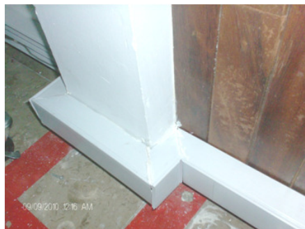
Figura 57. Canaleta fijada alrededor de la columna en el centro de servicio
