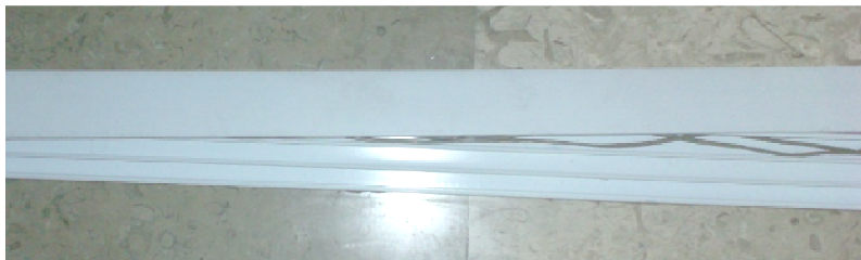
Figura 77. Cableado del área de la dirección general.
