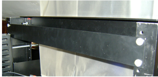
Figura 27. Parte superior del rack.
