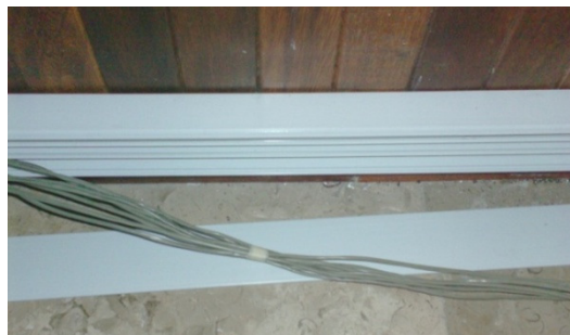
Figura 72. Cable telefónico en la canaleta.
