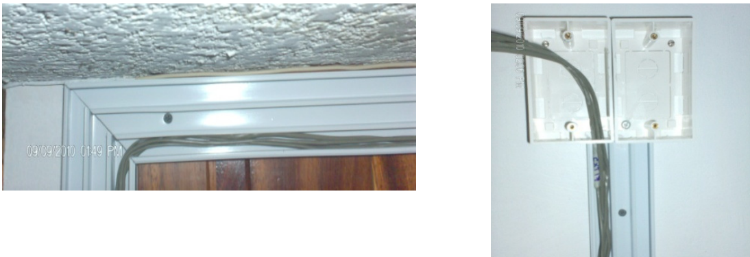
Figura 76. Cableado en el área de ventas.
