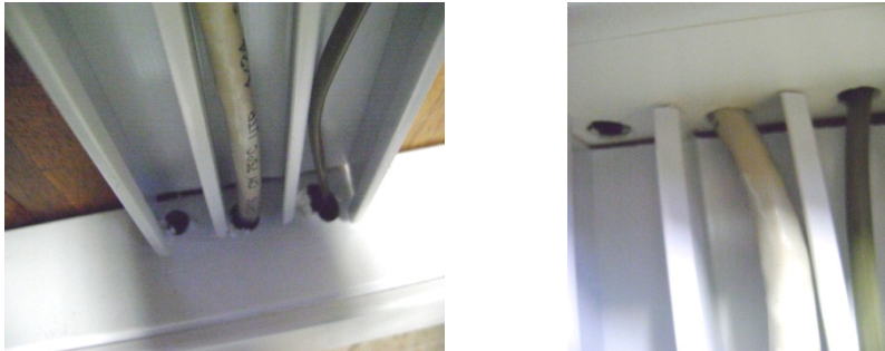
Figura 69. Orificios en la canaleta y en las cajas.
