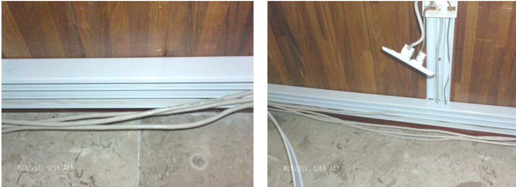
Figura 88. Cable UTP en la canaleta
