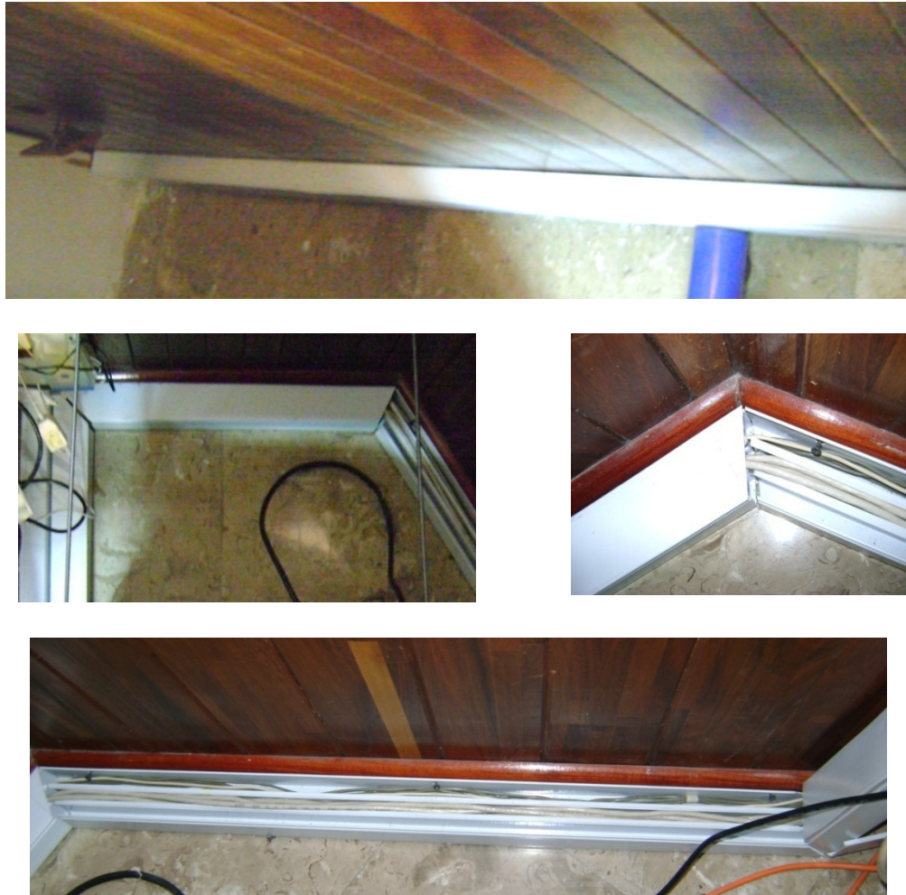
Figura 46. Canaleta instalada en el área de la dirección general y alrededores del rack
