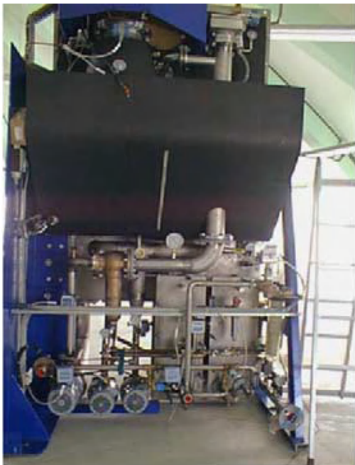
Figura 5.5. Planta de compresión de vapor, plato de intercambio de calor en la isla Gran Canaria (Tzen y Morris, 2003)
