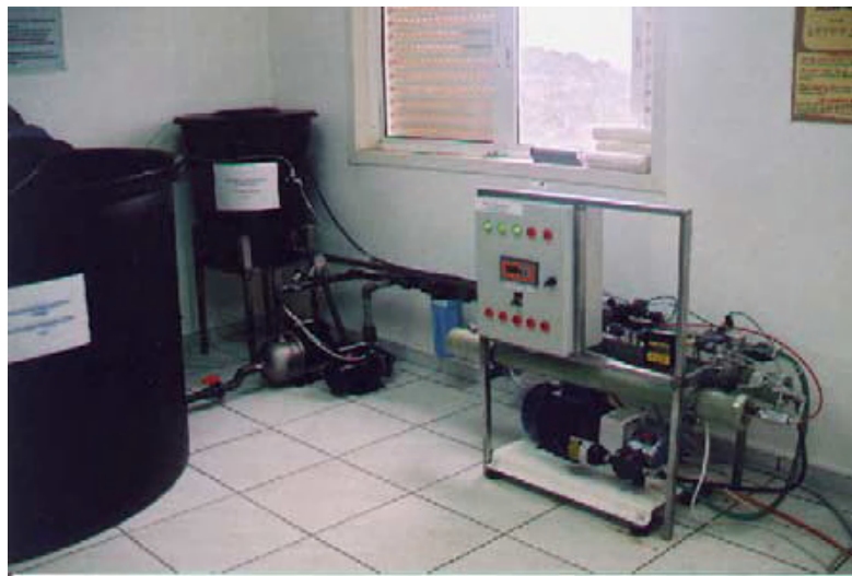
Figura 5.2. Unidad de ósmosis inversa que produce 130 L/h en Lavrio, Grecia (Tzen y Morris, 2003)
