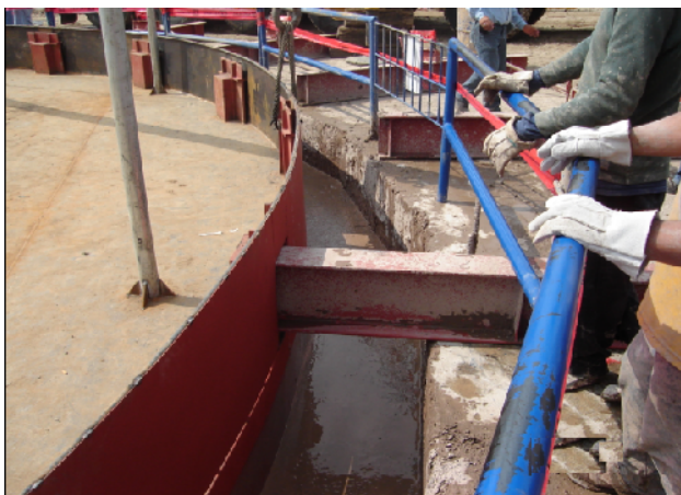
Figura 4.27 Anclaje de tanque con ayuda de vigas de sujeción
