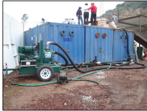
Figura 4.12 Bombeo de lodos.
