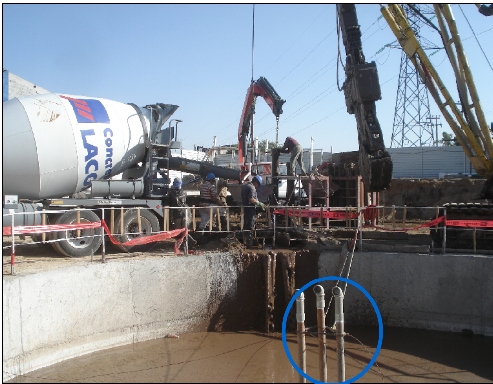
Figura 4.33 Tubería empleada en la inyección de mortero al fondo de la lumbrera
