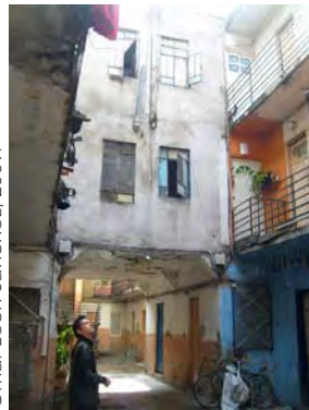
Deterioro del edificio Palmas Omar Leon Sánchez, 2009.
