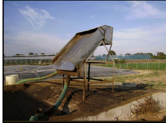
Figura 4.4 Digestor de la granja “La Estrella” (Marsilli, 2008)
