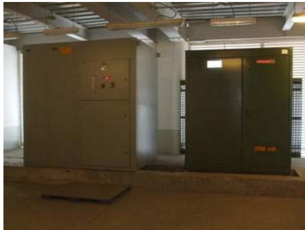
FIG 2.1 AREA DE SUBESTACIÓN.
