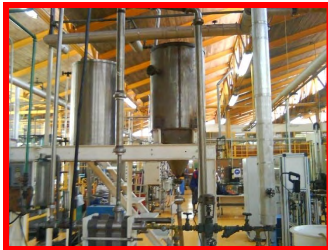
Fig. 5.10 Vista posterior de los tanques de los tanques de almacenamiento
