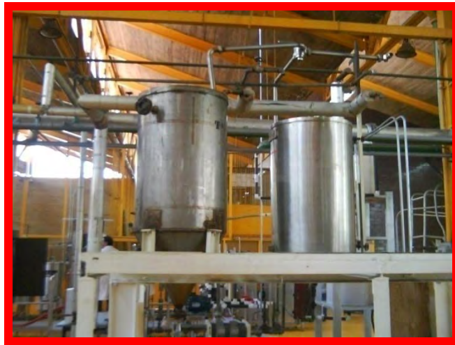
Fig. 5.9 Vista frontal de los tanques de los tanques de almacenamiento
