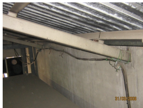
FOTO 3.2 Cable sin canalización.
