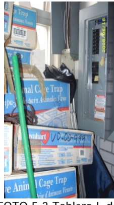
FOTO 5.3 Tablero L del edificio SILADIN B.
