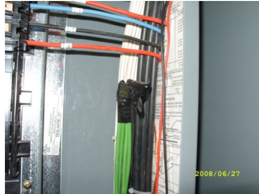
FOTO 2.1 Tablero Edificio de Cómputo sin barra de tierra aislada.
