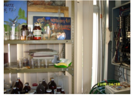
FOTO 5.5 Tablero M del edificio SILADIN B.
