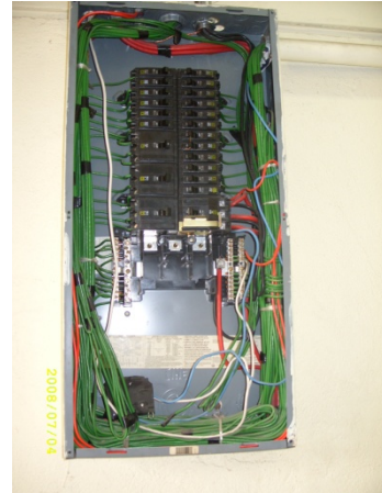
Foto 3.5 Tablero C edificio Galerón.
