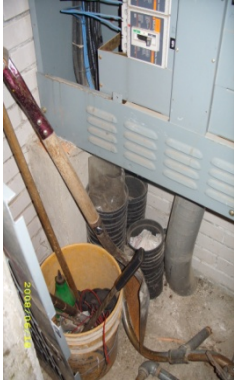
FOTO 5.2 Tablero general SILADIN B.
