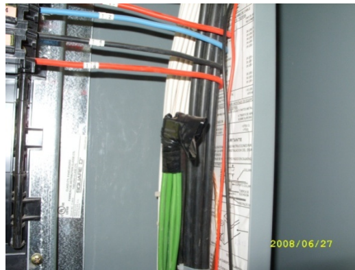
FOTO 5.1 Tablero Edificio de Cómputo sin barra de tierra aislada.
