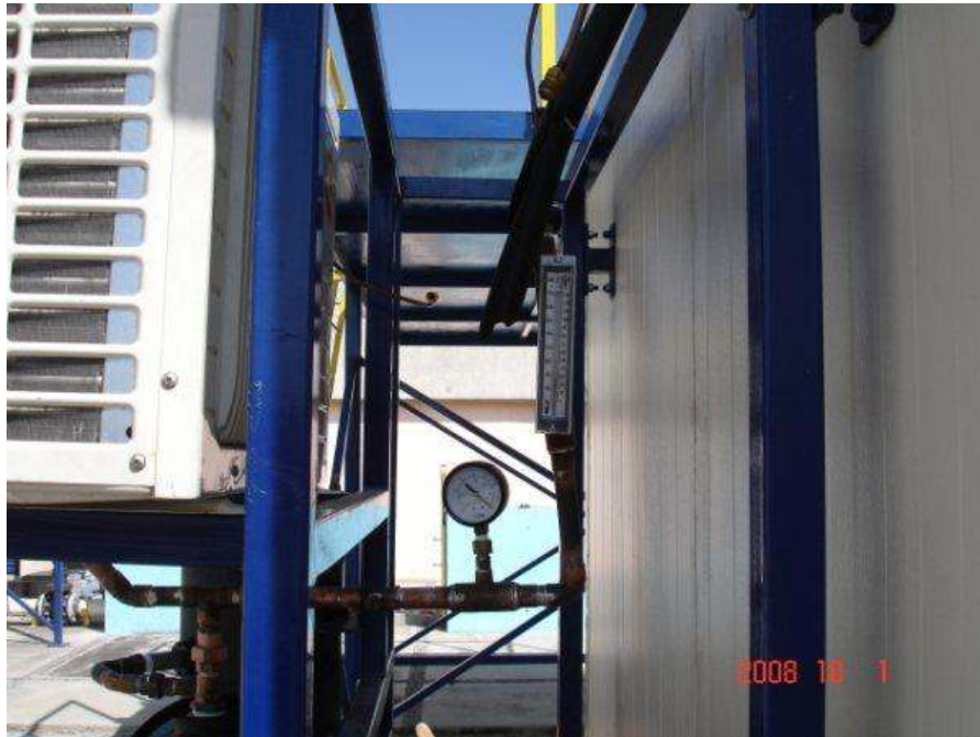
Figura 4.2 Posición actual del condensador
