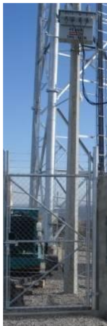
Figura 39. Subestación tipo poste.
