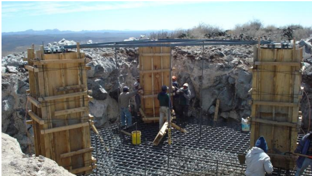
Figura 24. Kit armado para su supervisión.
