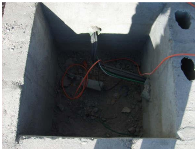
Figura 32. Cableado para acometida.
