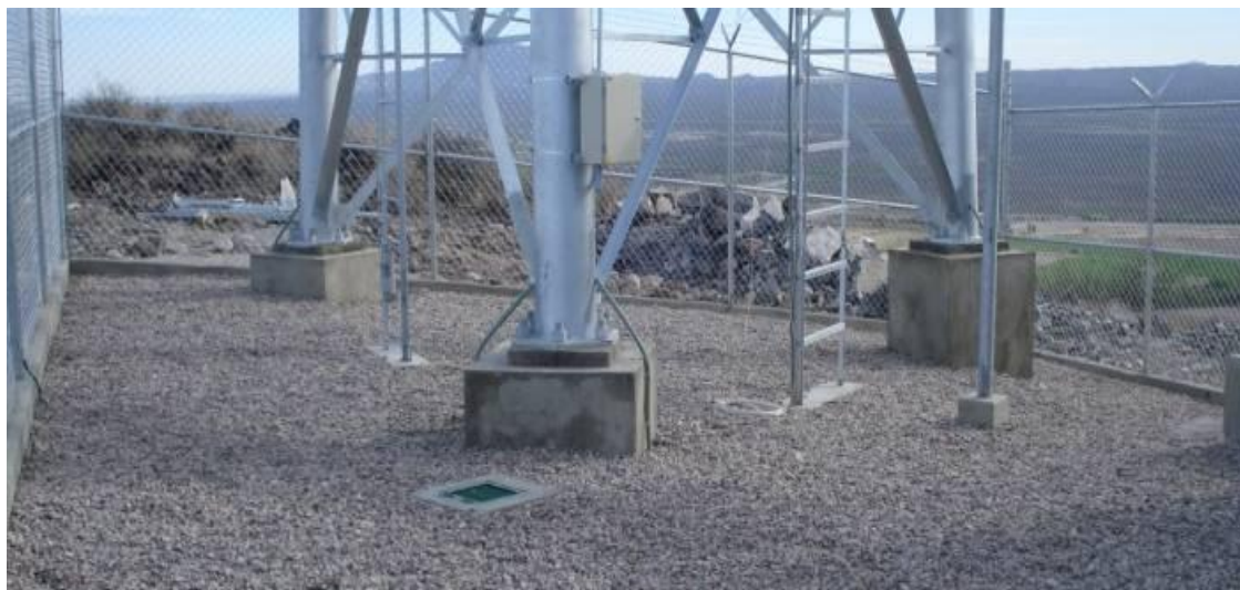
Figura 41. Registro del sistema de tierras.
