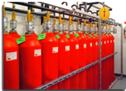
Tanques contenedores de CO 2
