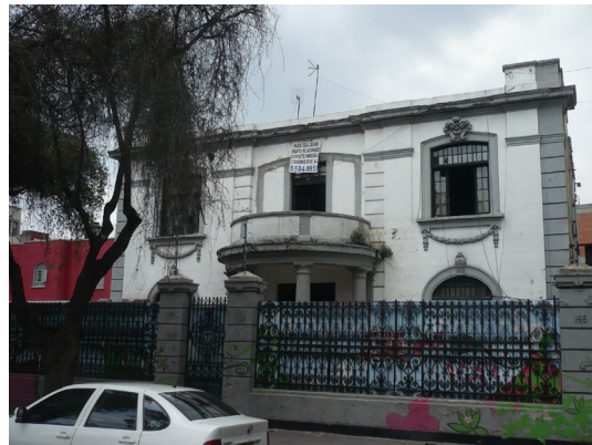
Imagen 30 y 31; estado actual de la casa unifamiliar ubicada en Orizaba 146, este inmueble es el objeto de estudio de la Maestría.
