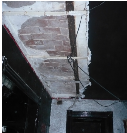
Imagen 38, detalle de los deterioros en la cubierta de Orizaba 146 ocasionados por las filtraciones en la bóveda catalana. Fotografía tomada por el autor, 2008.
