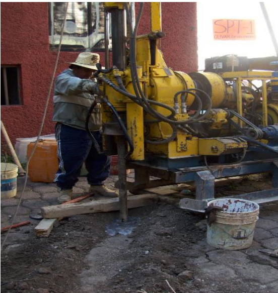
Inicio del sondeo, realizando el primer avance en el suelo con la broca tricónica.
