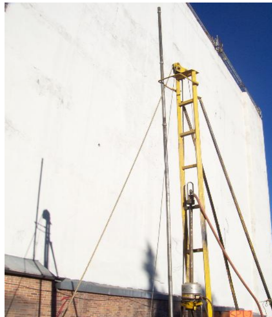
Imagen de las barras acopladas, conforme se avanza en la profundidad del sondeo.
