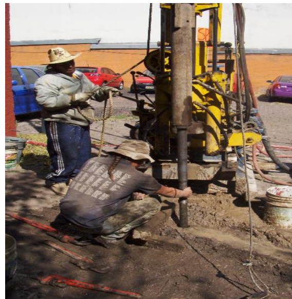
Hincado del tubo partido con ayuda del martinete, para la obtención de la muestra alterada de suelo.
