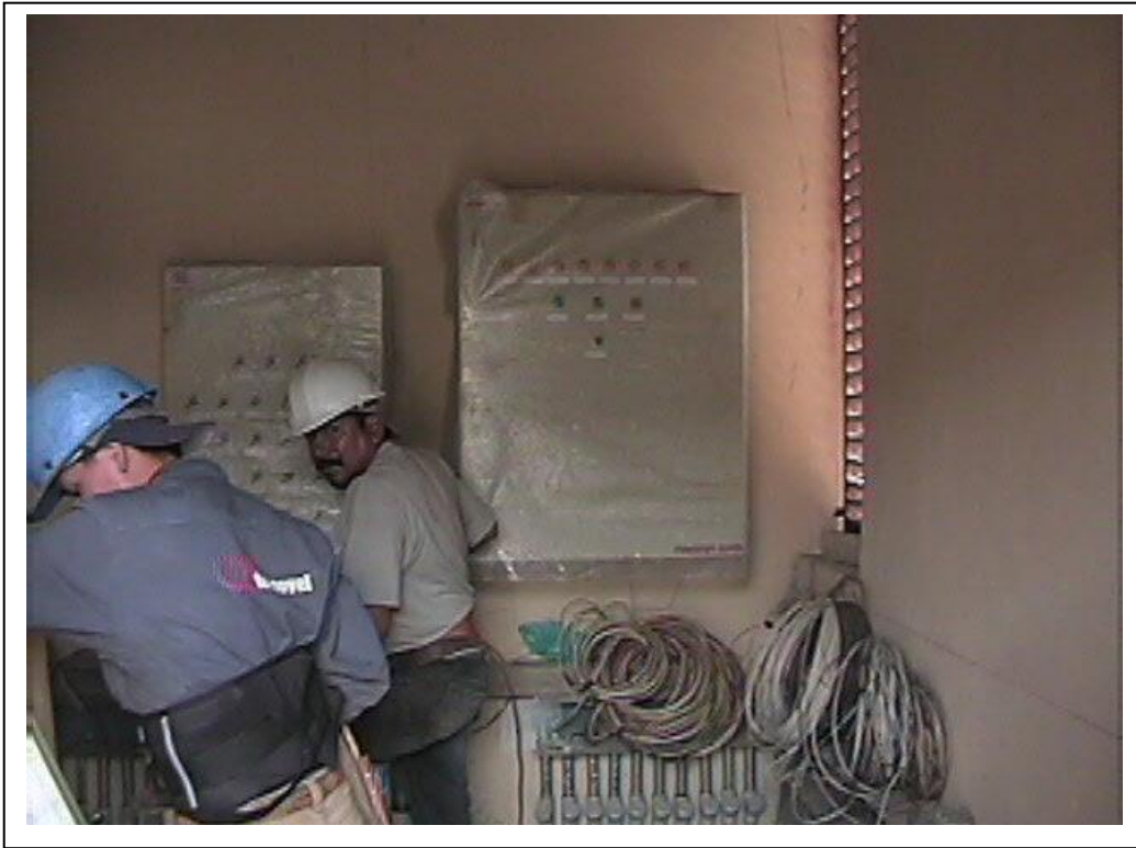
Foto 21 Conexión de tableros de control
