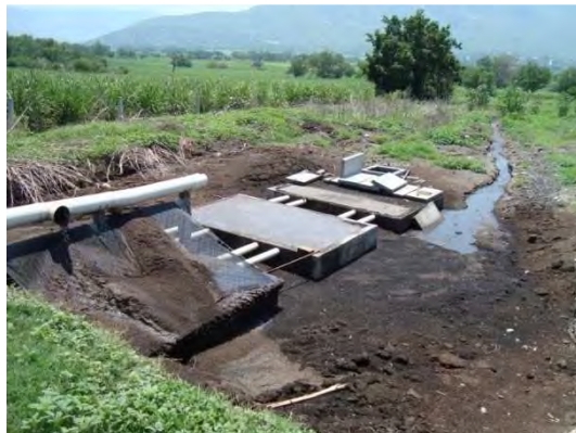
Figura 6. Fotografía de la salida del agua residual que proviene de la granja porcícola
