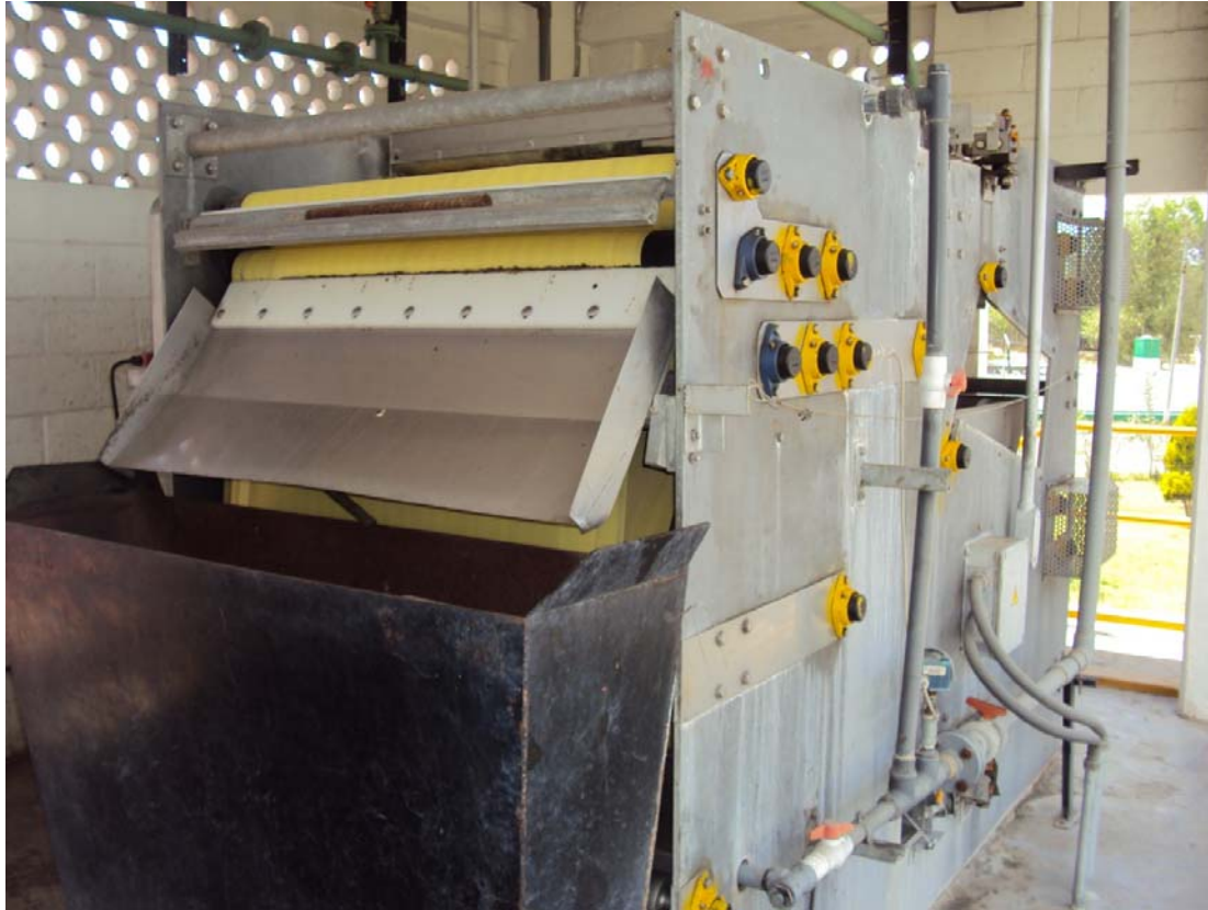
Figura 8.- Filtro banda, donde a través de una acción mecánica se deshidrata al lodo.
