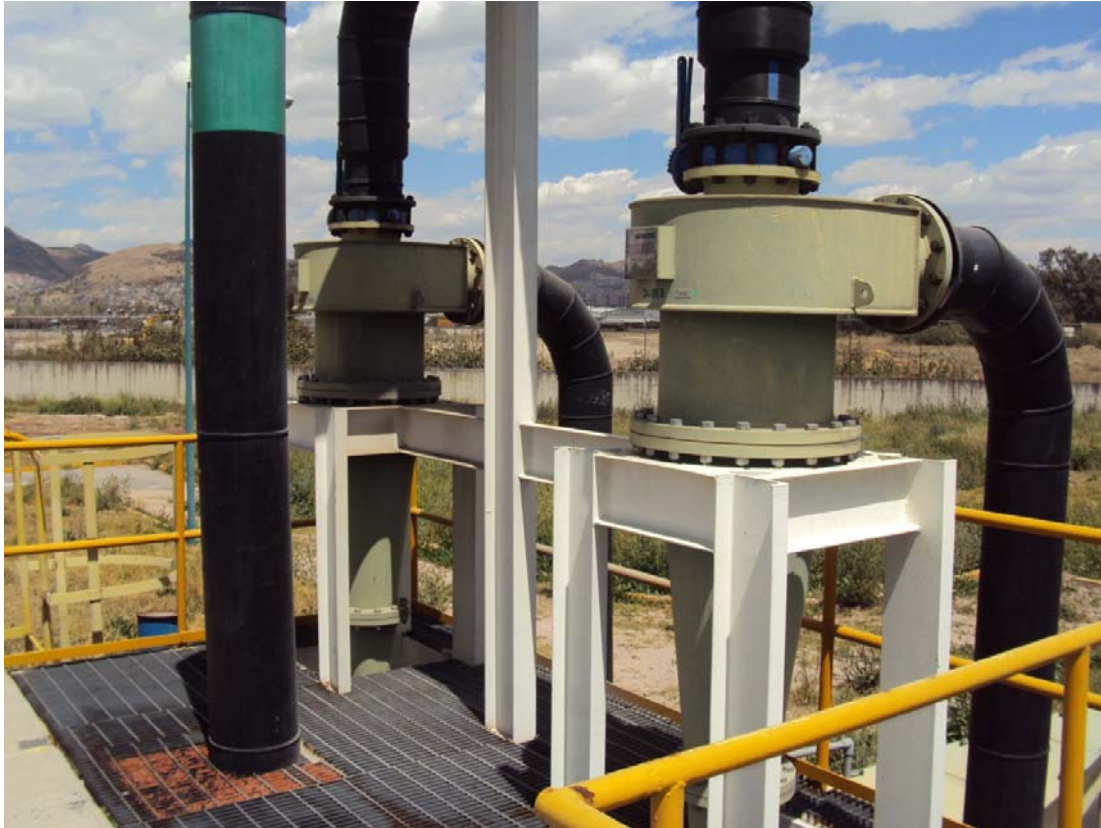
Figura 1.-Desarenador donde se retiene la grava y la arena por gravedad.
