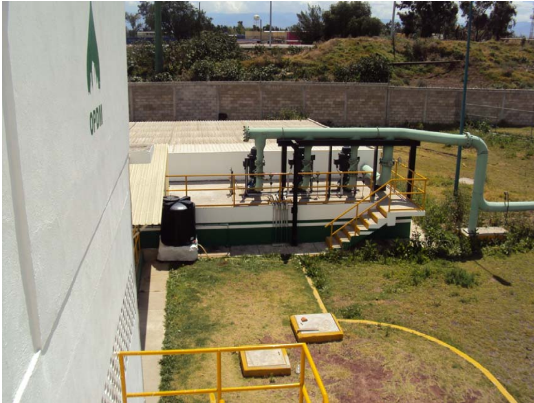
Figura 6.- Tanque de almacenamiento de agua residual tratada.
