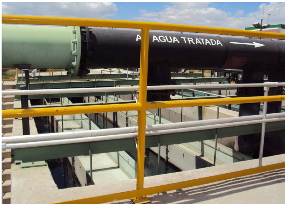
Figura 5.- Filtros arena, el cual retiene sólidos en suspensión.
