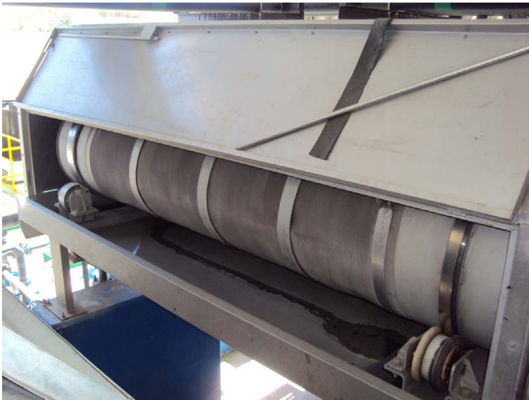
Figura 7.- Espesador de lodos, aquí se concentra el lodo y se elimina el agua por filtración.
