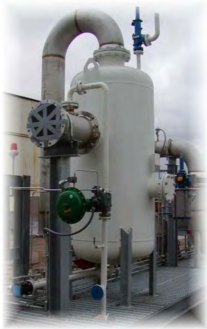
Fotografía 2.7-Tanque de Desfogue Vertical
