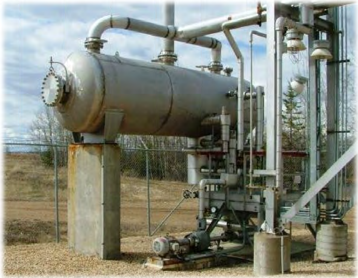
Fotografía 2.8 Tanque de Desfogue Horizontal.
