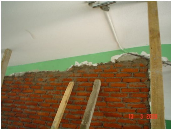
DISCONTINUIDAD ESTRUCTURAL EN MUROS DE CARGA
