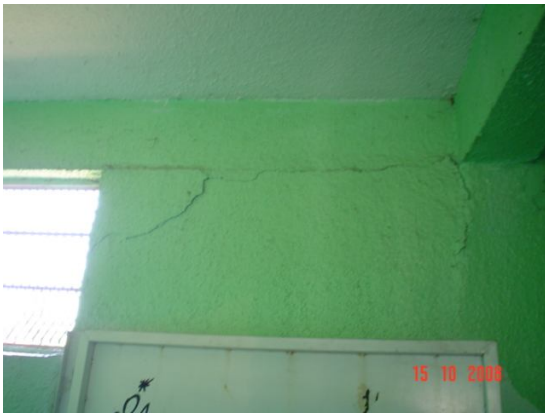
GRIETAS EN MUROS CAUSADAS POR ASENTAMIENTOS
