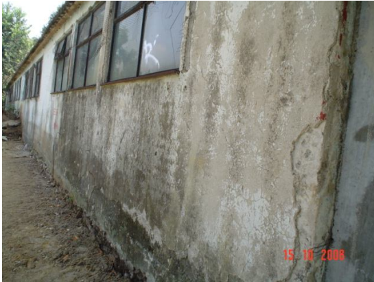
DETERIORO DE FACHADA
