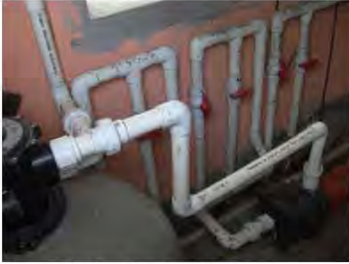
37. Cuartos de máquinas
