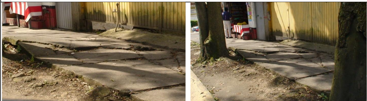
Foto 342 y 343: Pavimentos de las banquetas cercanas a la Quinta de las Rosas, fracturado por la raíz de los árboles. Elaborada por la autora.
