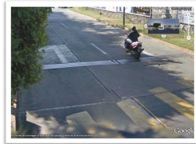
Rejilla de captación y redirección de agua pluvial
