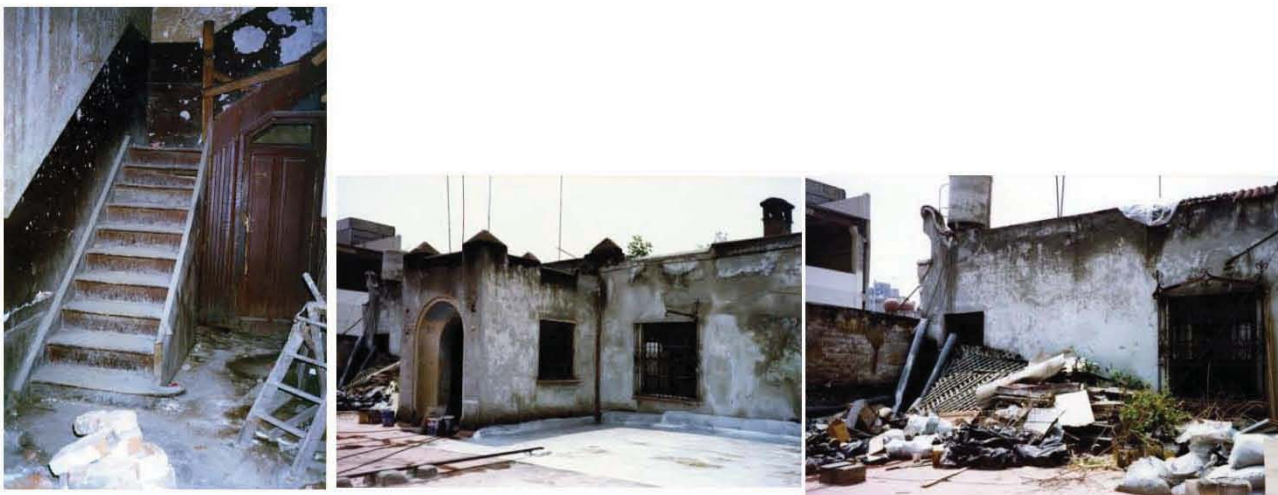
Imagen 26, 27 y 28. La imagen 26 muestra el estado deplorable de las escaleras de madera que conducen a la azotea, la número 27 es la salida hacia la azotea, podemos observar un descuido total de la misma, el departamento que alguna vez existió se encuentra en ruinas y lleno de humedad en muros.
