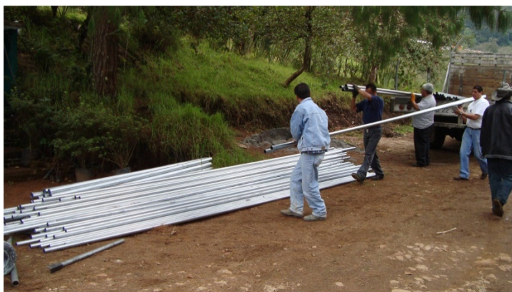
Fig. 15. Descargue de material para la construcción de la UMA Paraje la Joya.
