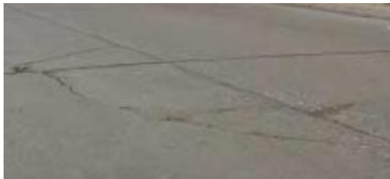
Figura 4.2. Fisuras de esquina.
