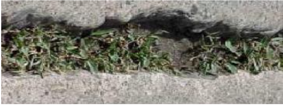
Figura 4.4 Daño en el sellado de juntas
