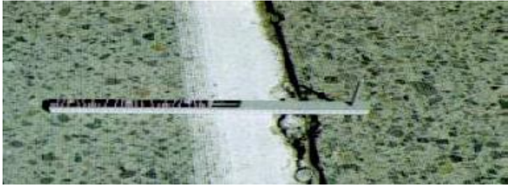
Figura 4.6 Fracturación en los bordes de las losas
