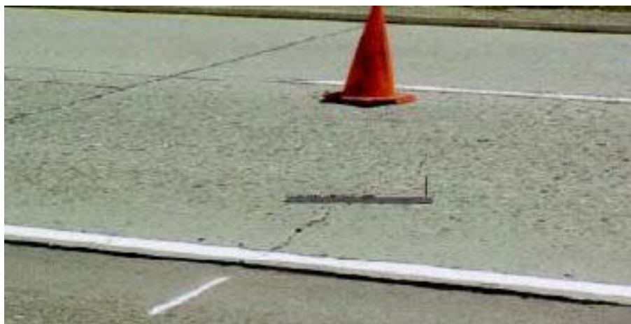
Figura 4.7. Fractura de la losa perpendicular al eje del pavimento.
