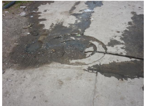
FIGURA 22.- Coladera tapada en el Poblado de Tres Marías, Mor.
