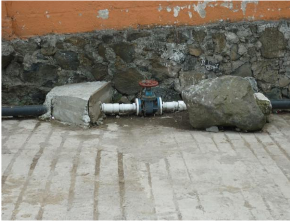
FIGURA 21.- Forma de abastecimiento del agua potable
