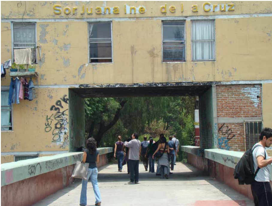
Unidad Habitacional deteriorada y con graves problemas de hacinamiento, delincuencia, entre otros en El Rosario, Azcapotzalco.(2009)
