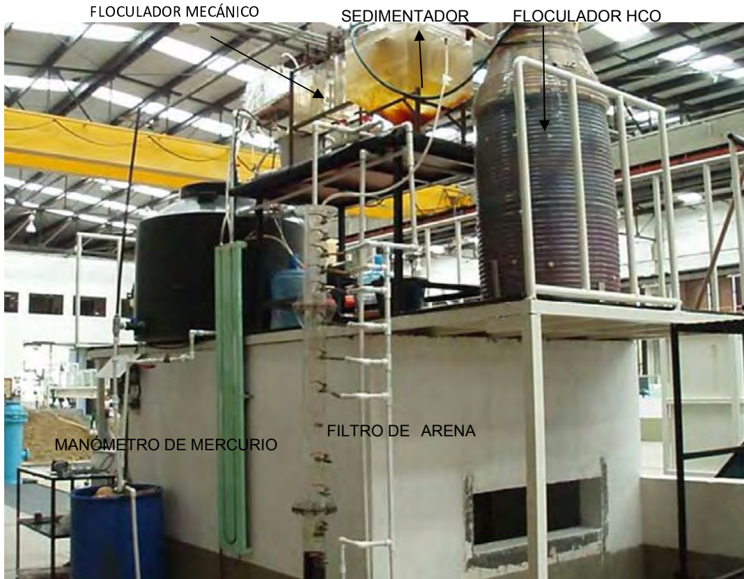
Figura 3.6. Montaje experimental de la unidad piloto de clarificación.
