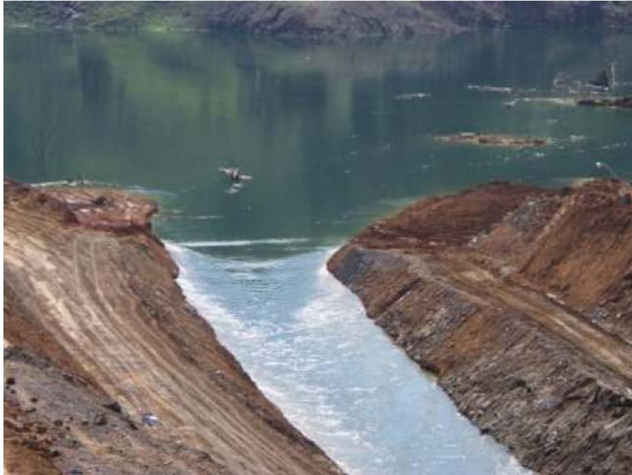
Figura 2.15. Canal operando. Cortesía CPH-CFE.
