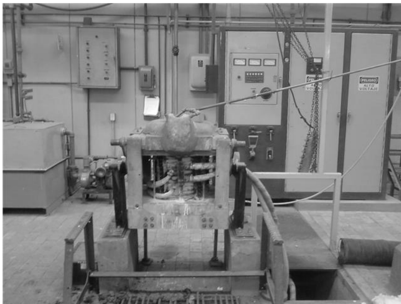
Figura 3.5.- Horno de inducción de alta frecuencia.
