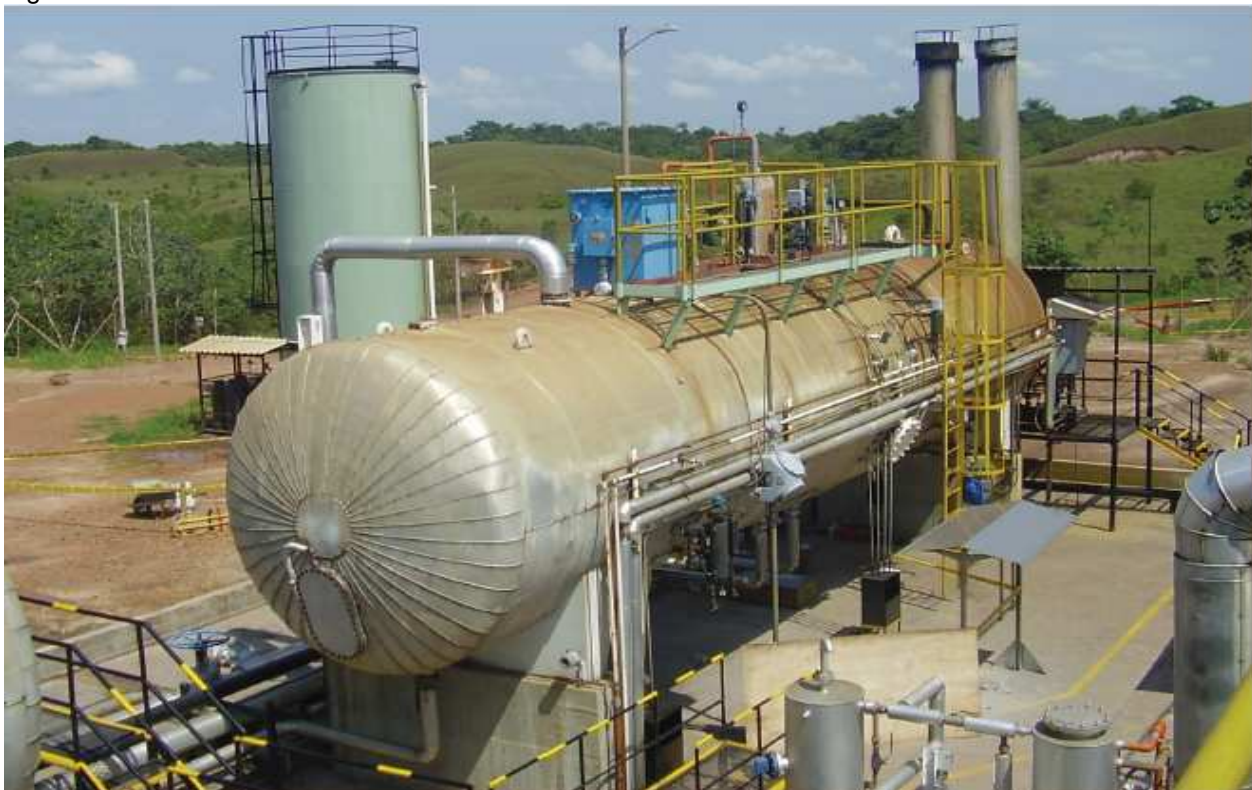
Figura 98: Tecnología de deshidratación de dual frecuencia en Campo Rubiales en Colombia después de retrofit . Ref. Dual Frequency dehydration technology at Rubiales Field in Colombia
