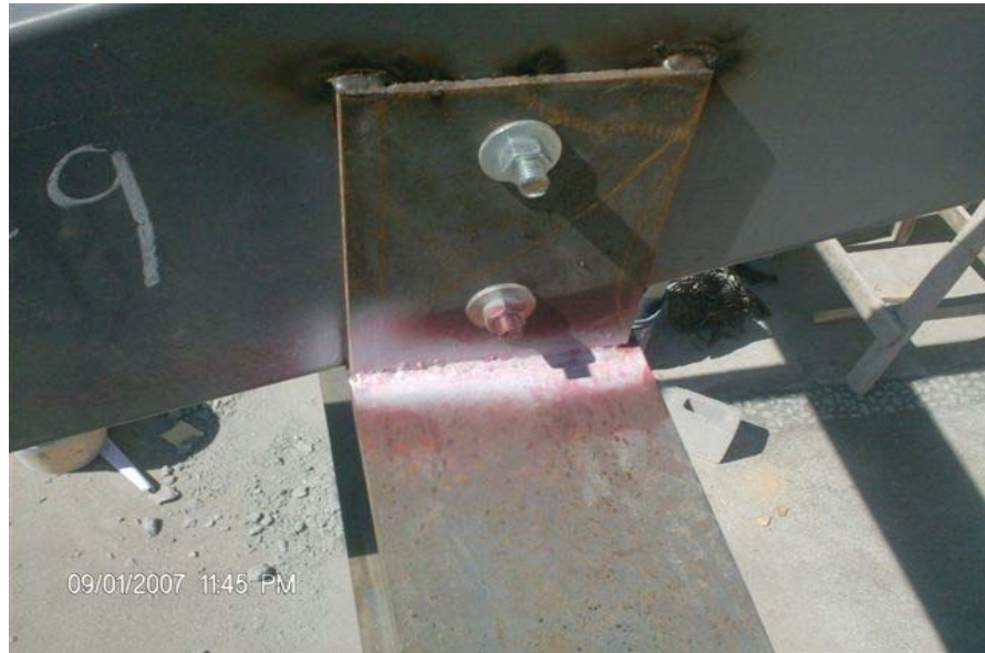
Fig. II.3 Unión sujeta a la prueba de líquidos penetrantes.
