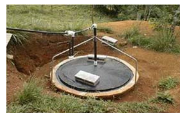
Fig. 96 Biogestor FUENTE: http://images.google .
