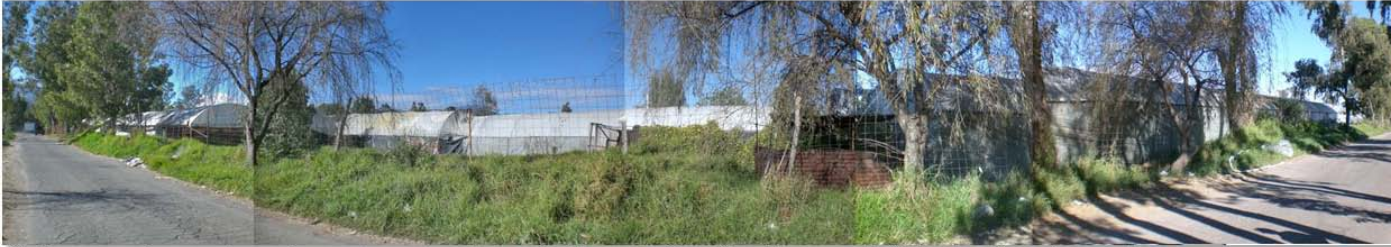
3.-Invernaderos abandonados sobre la calle Puente Urrutia - Permeabilidad y diversidad de uso-
