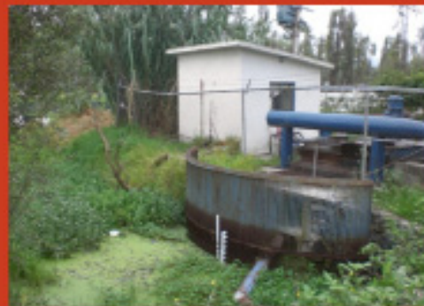
Vista 2 : Cuarto y maquinaria de bombeo.
