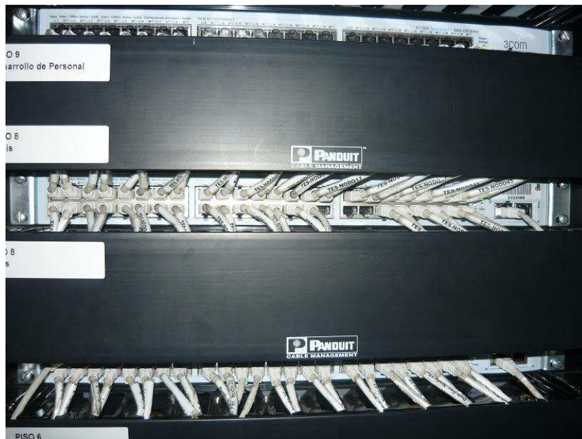
Imagen 5.4 Switches en piso 8
