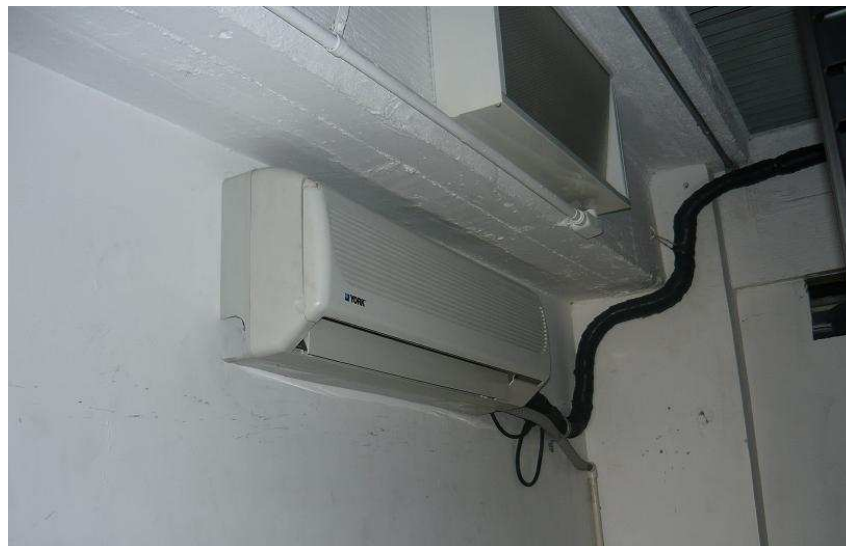
Imagen 4.1 Sistema de aire acondicionado
