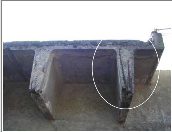
Figura N°66. Agrietamiento y delaminaciones en superficies de la estructura.
