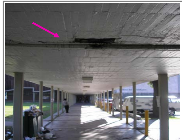
Figura N°69. Corrosión en circulaciones techadas en dirección al Posgrado de Arquitectura.
