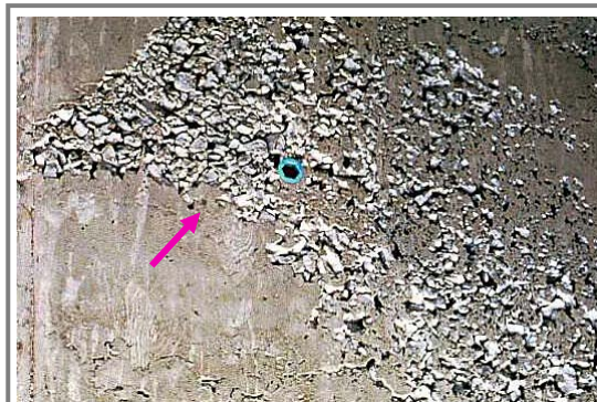
Figura N°40. Exposición del agregado grueso en las superficies de concreto aparente, defecto importante de considerar y reparar.
