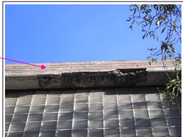
Figura N°65. Acercamiento de la sintomatología presentada en el edificio Facultad de Arquitectura.
