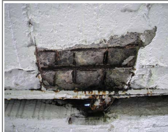
Figura N°68. Fenómeno de corrosión del acero de refuerzo
