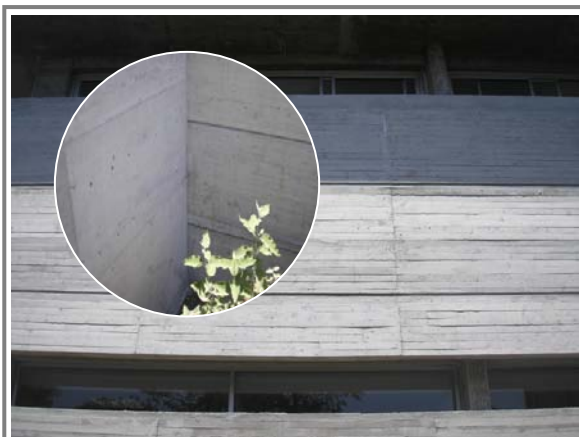
Figura N°113. Defecto 13 de modulación importante.
