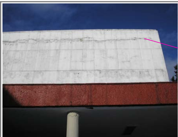
Figura N°62. Manifesto sintomatológico determinado por la fisuración longitudinal de la estructura.
