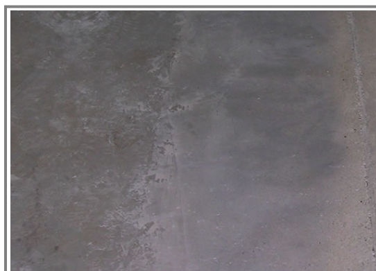
Figura N°42. Manchas en las superficies que demuestran algún trabajo efectuado en forma incorrecta.
