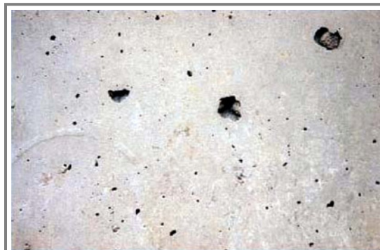
Figura N°38. Burbujas que conforman un defecto superficial que debemos atender y superar para la calidad de las envolventes arquitectónicas de concreto armado aparente.
