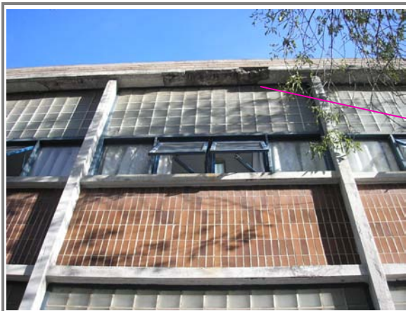
Figura N°64. Sintomatología delaminación del concreto, generando desprendimiento del
