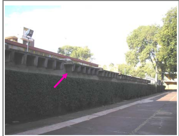
Figura N°67. Ubicación del desprendimiento del concreto en instalaciones de la Facultad de Ingeniería.
