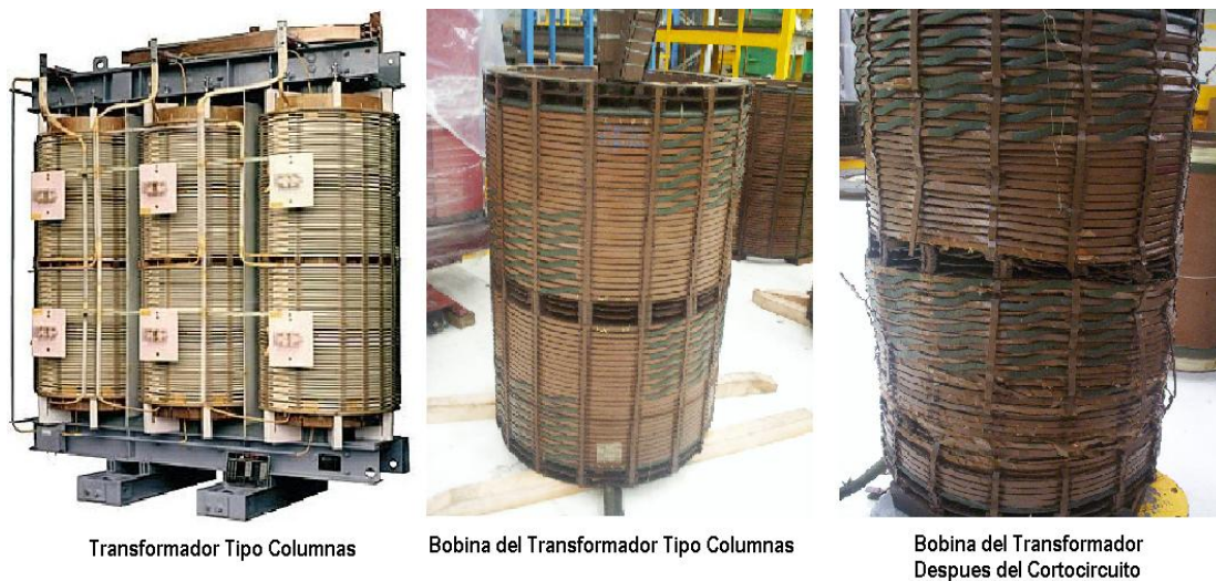
Figura 4.3.- Cortocircuito en las Bobinas del Transformador.
