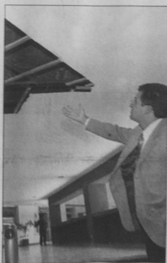
El director muestra el deterioro de sus instalaciones por falta de mantenimiento
