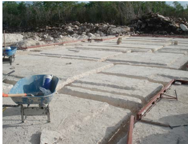
Fig. 4 Sistema de Cimbra y Excavación de cepas para instalaciones sanitarias y pluviales
