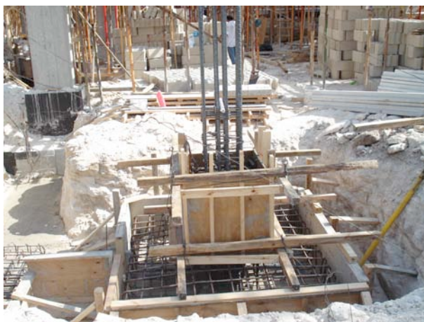
Zapata Aislada sobre roca Sana (sobre estrato de Sascab) en Playa del Carmen
