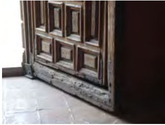
Detalle de la parte baja, de la puerta de acceso principal, en la que se muestra el perno metálico que sirve como bibel, así como los refuerzos en escuadra en las equinas de la puerta.
