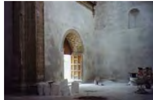
Vista de la aplicación de aplanado, para recibir pintura a la cal.
