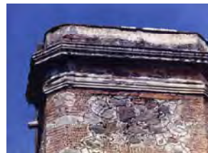
Fabrica en muros; a base de mampostería de piedra, tabique y tezontle.
