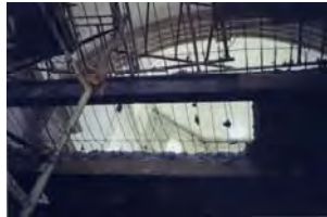
Vista de la losa de entrepiso al ser demolida para retirarla (en 1997).
