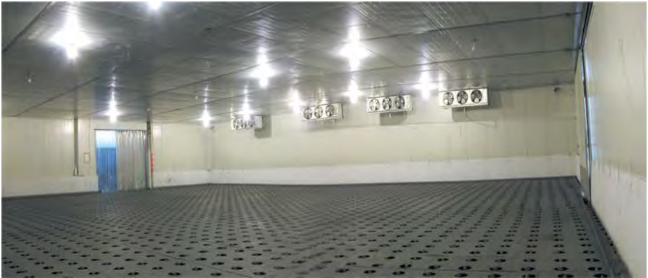
Figura 42. Bodega de refrigeración
