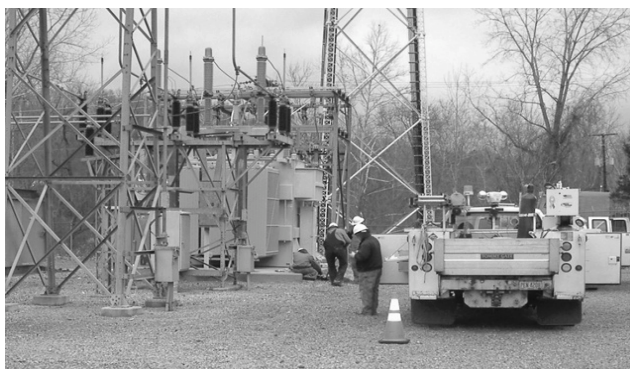
Figura 4.12 Subestación Sullivan, Tennessee, USA.
