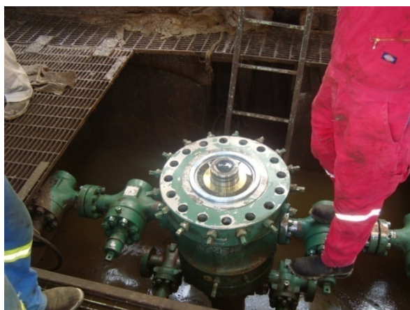
FIGURA 3-11. Cabezal Preparado para la Instalación del Medio Árbol de Válvulas.
