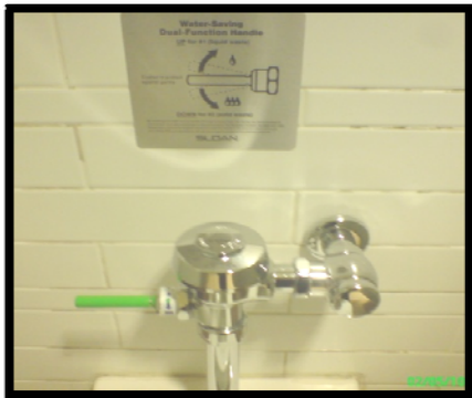
Figura 4.1 Fluxómetro de doble descarga. En el aeropuerto de Calagary, Canadá, los inodoros cuentan con la tecnología dual-flush handle que permite ahorrar agua, suministrando una descarga de cuatro litros si se sube la manija, y de seis litros si se baja. Fuente: Tomada por la autora.
