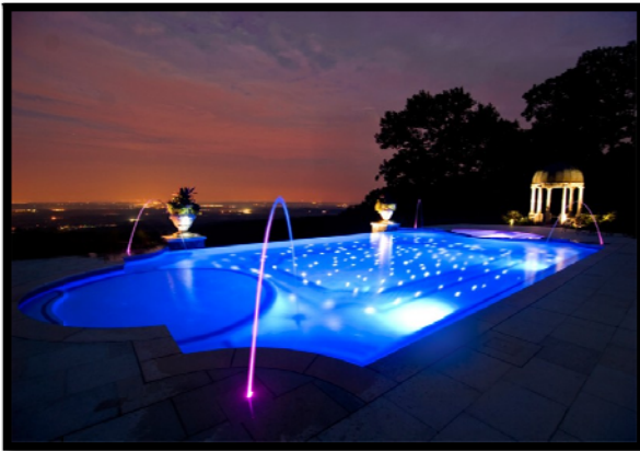
Figura 3.8 Fibra óptica subacuática. Mediante el uso de sistemas de iluminación puntual se puede conectar lentes subacuáticos para iluminación de albercas. Las principales ventajas del uso de la fibra óptica es que no conduce electricidad, calor o gases, permite el cambio de color en la iluminación, es muy durable, de bajo consumo energético y prácticamente no necesita mantenimiento. Fuente: Sitio web Architecture Things
