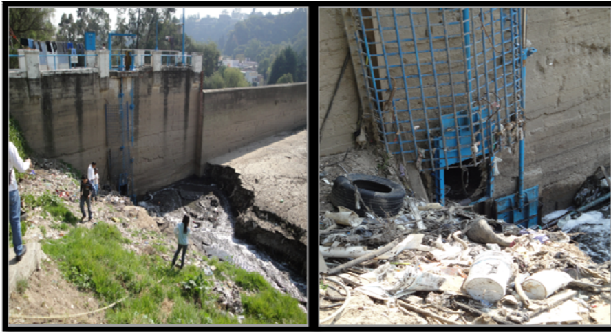
Figura 1.2 Presa “El Capulín”. Un claro ejemplo de las consecuencias de no tomar en cuenta la deconstrucción de un proyecto al final de su vida útil. Fuente: Tomadas por Francisco Peña.
