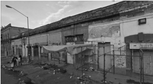
Fig. 53. Fachada de vecindad en la Calle de Jesús Carranza. Deteriorada severamente, limita con un frente comercial, esta calle es una de las más concurridas por el comercio informal y es común que
