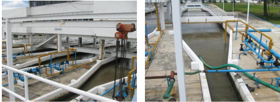
Figura 1.4 Medidores Parshall en la planta Los Berros
