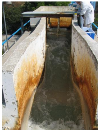
a) Canal Parshall
