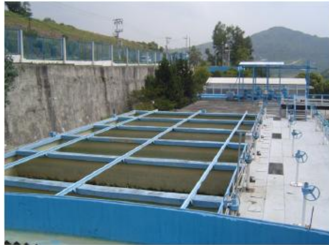
b) Batería de tanques de filtración
