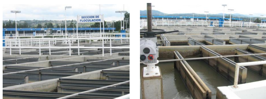
Figura 1.5 Sección de floculación en la planta Los Berros
