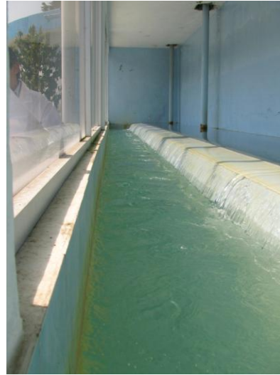
b) Agua potable almacenada
