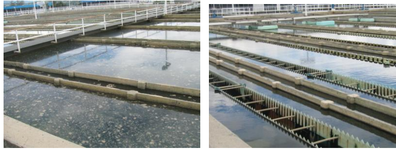
Figura 1.6 Sección de sedimentación en la planta Los Berros
