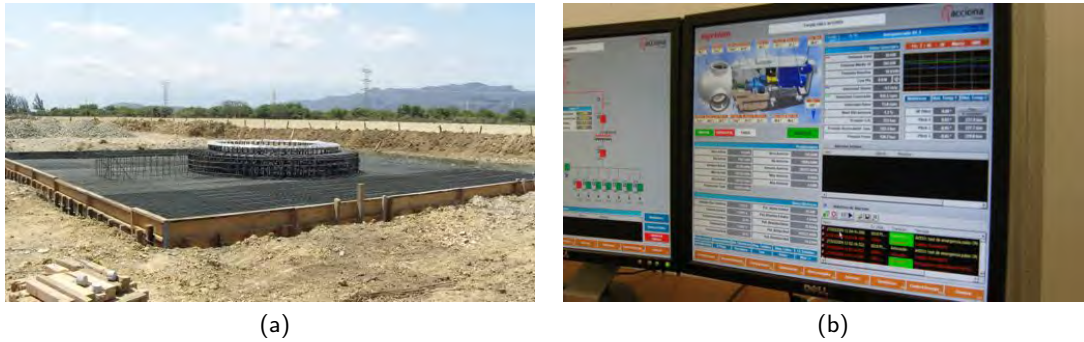
Figura 2.2.4: Cimentación de un aerogenerador (a) y computadoras de monitoreo y control (b).
